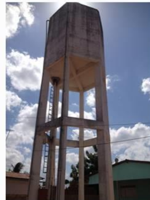
Figura 1. Detalhes do reservatório elevado que abastece 42 residências na comunidade de Catolé. Fonte: Comitê Executivo do PMSB de Santa Maria, 2017.
