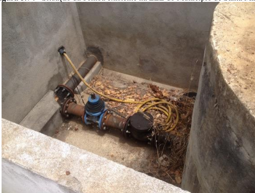
Figura 3.74 - Situação da bomba existente na EEE do Município de Santa Maria.
