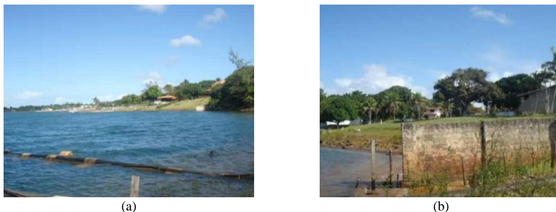
Figura 3.62 - Vulnerabilidade do ponto de captação do Sistema Integrado da Adutora Monsenhor Expedito: Detalhe do ponto de captação (a) e Detalhe do ponto de captação (b).
