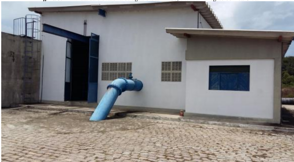
Figura 3.22 - Vista da elevatória de água bruta EB 00, situada na região de Boa Cica.
