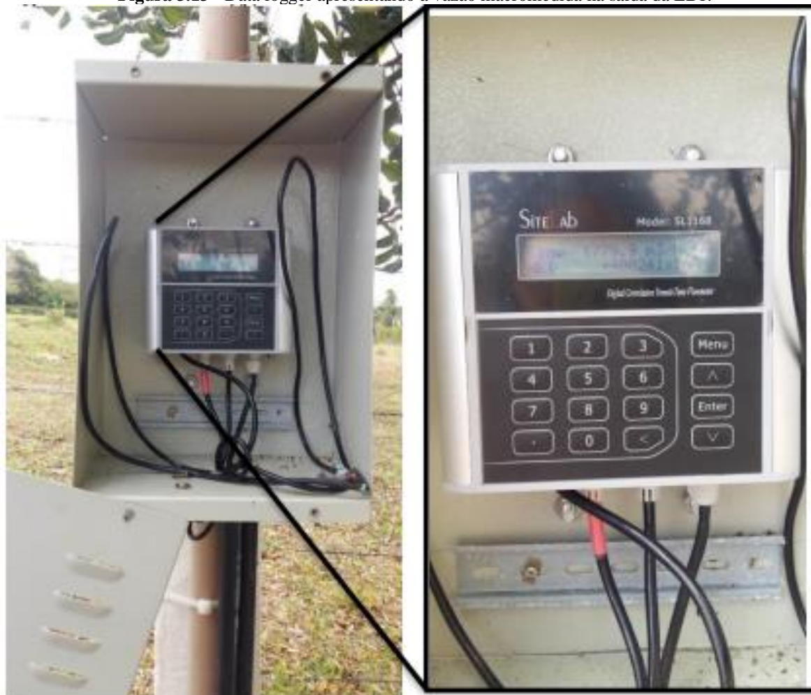
Figura 3.13 - Data logger apresentando a vazão macromedida na saída da EB1.
