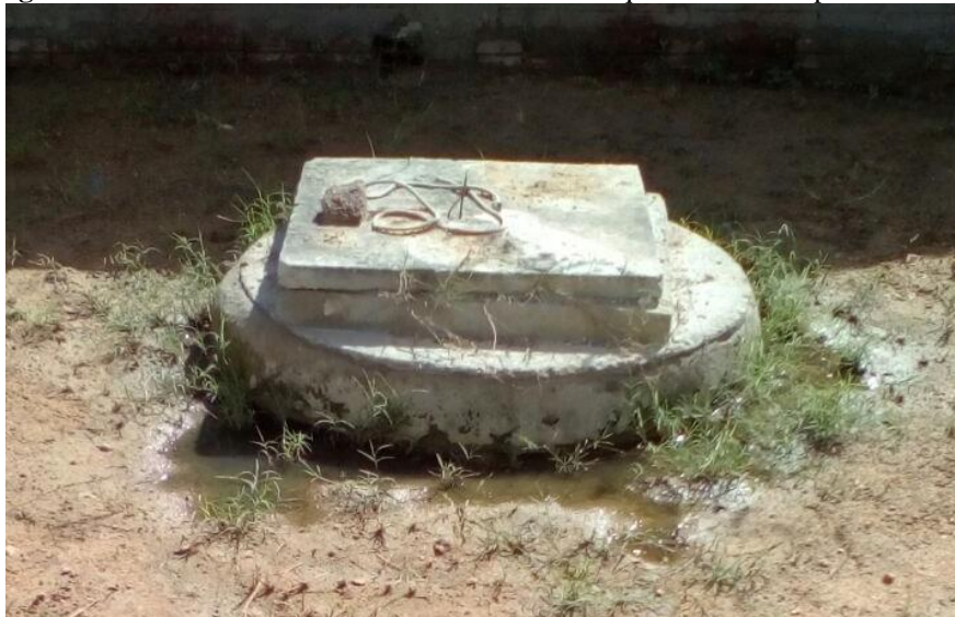
Figura 3.65 - Fossa no Bairro Alto de São Francisco que extravasou após as chuvas.
