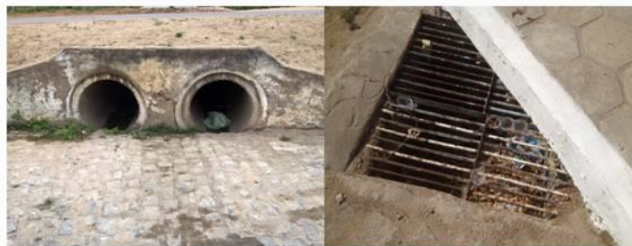
Figura 18. Interferência de resíduos sólidos nos elementos do sistema de drenagem urbana. Fonte: Comitê Executivo do PMSB de Santa Maria, 2017.
