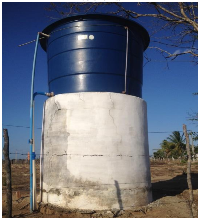
Figura 3.49 - Detalhes reservatório elevado particular existente em propriedade privada na comunidade de Jurumenha.
