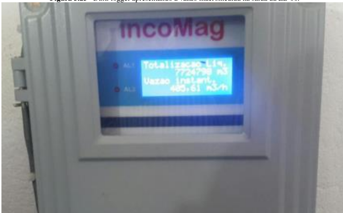
Figura 3.25 - Data logger apresentando a vazão macromedida na saída da EB 00.
