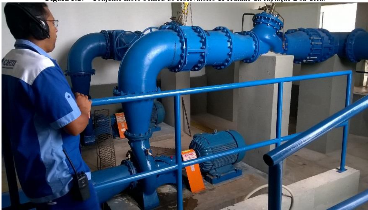
Figura 3.17 - Conjunto moto bomba do reservatório de reunião da captação Boa Cica.
