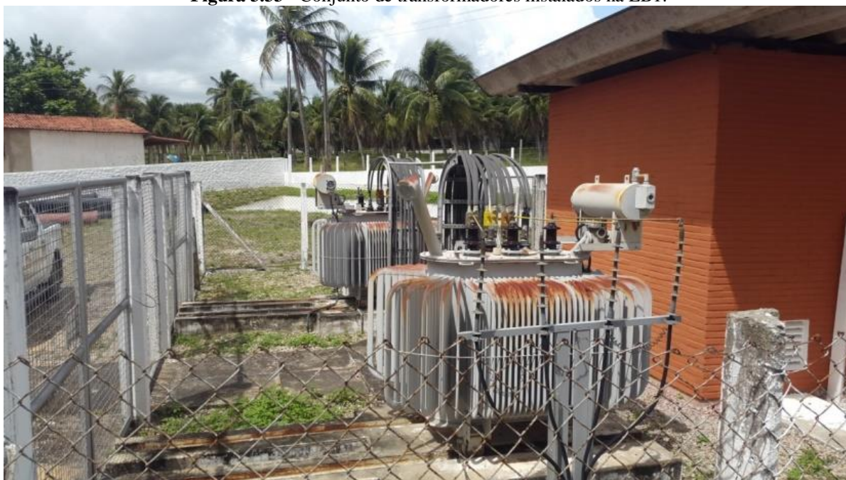
Figura 3.33 - Conjunto de transformadores instalados na EB1.
