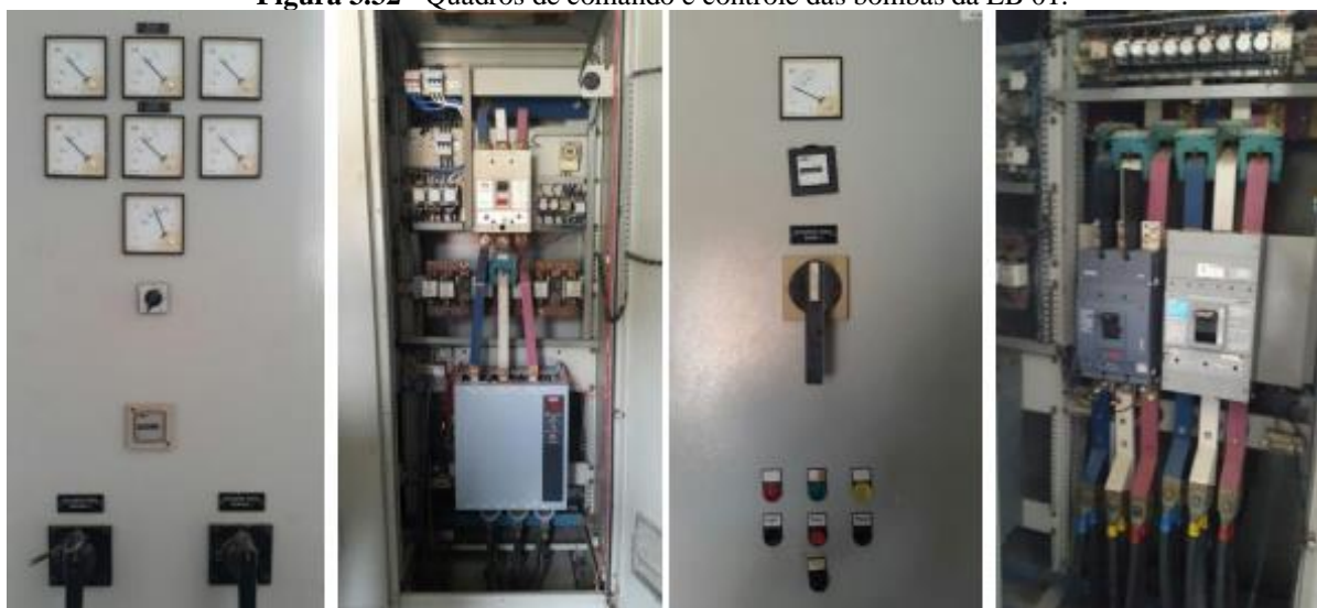
Figura 3.32 - Quadros de comando e controle das bombas da EB 01.
