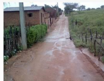
Figura 12. Área sujeita a alagamentos em Caiçara que dificulta a mobilidade da população. Fonte: Comitê Executivo do PMSB de Santa Maria, 2017.
