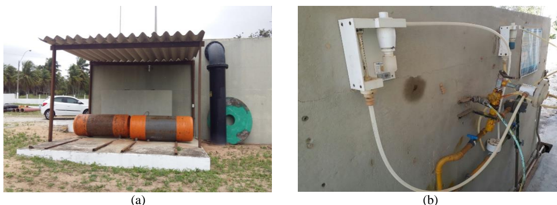
Figura 3.30 - Unidade de desinfecção do Sistema Adutor Monsenhor Expedito: Cilindros de cloro gás instalados na EB 01 (a) e equipamentos para dosagem do reagente (b).
