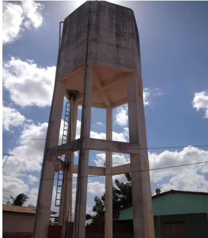
Figura 3.48 - Detalhes do reservatório elevado que abastece 42 residências na sub localidade de Catolé.
