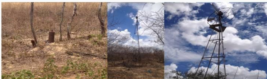
Figura 6. Poços públicos existentes (quatro) em Santa Maria II – Bancos. Fonte: Equipe de elaboração do PMSB/UFRN, 2017.
