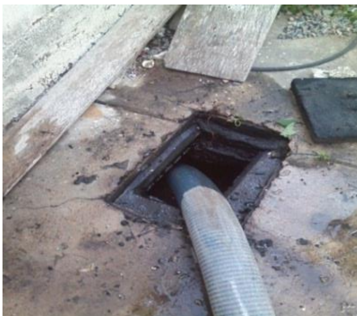
Figura 3.64 - Fossa passando pelo processo de esgotamento sanitário.
