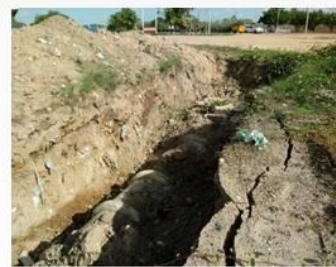
Figura 14. Rede de drenagem existente na Avenida Presidente Juscelino. Fonte: Comitê Executivo do PMSB de Santa Maria, 2017.
