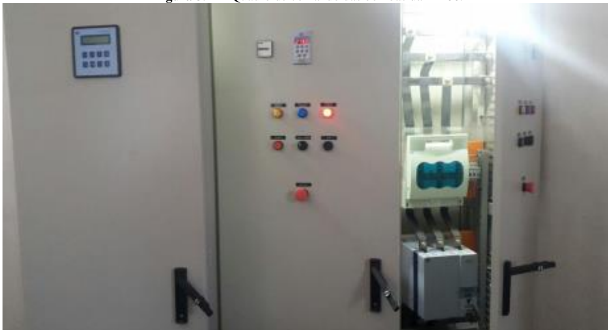
Figura 3.24 - Quadro de comando das bombas da EB 00.
