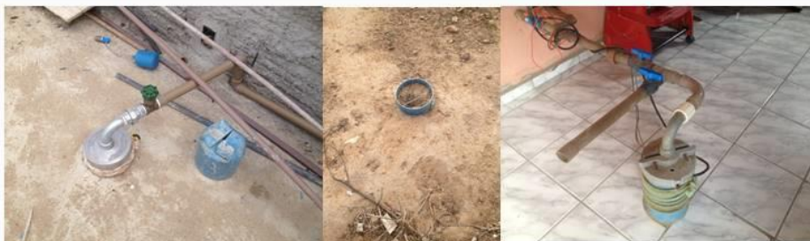
Figura 6. Poços existentes em Vila Tota Azevedo (dois particulares e um público). Fonte: Equipe de elaboração do PMSB/UFRN, 2017.
