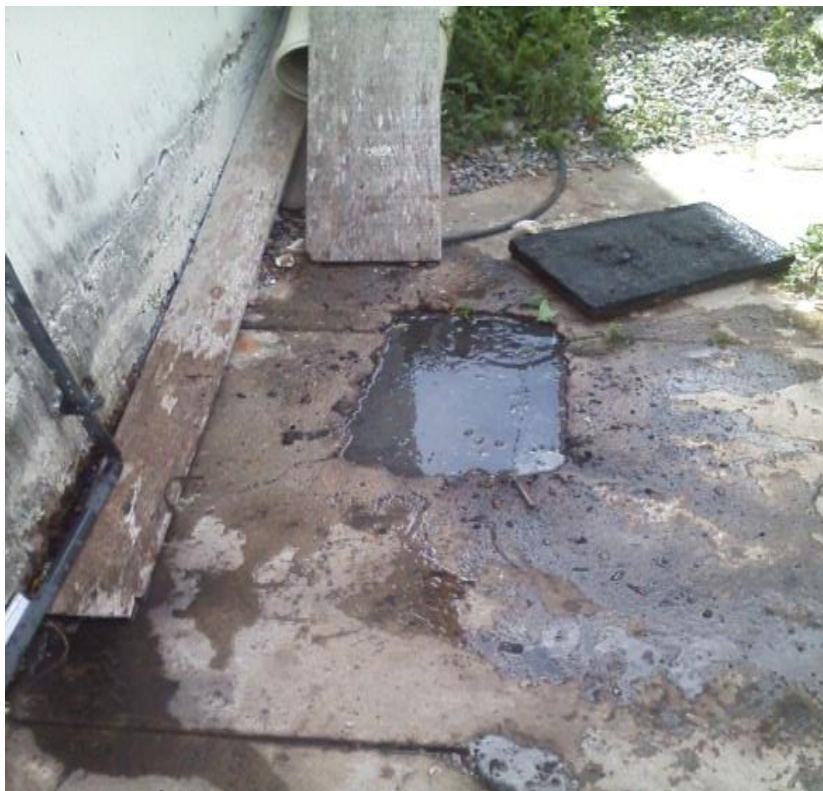
Figura 3.66 - Residência afetada por problemas no sistema de esgotamento sanitário.
